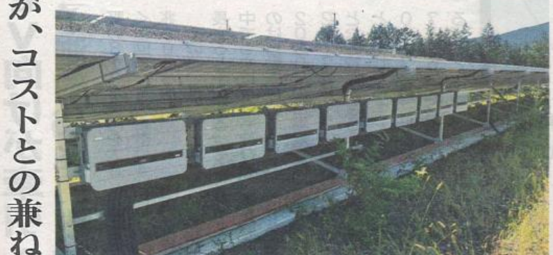
【イメージ】複数台のPCSを設置するタイプの発電所の例
